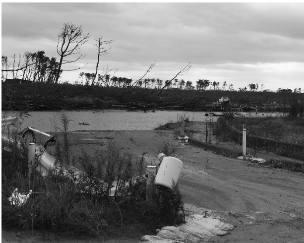
図 1 地震により分断されたままの道路 (南蒲生地区)
