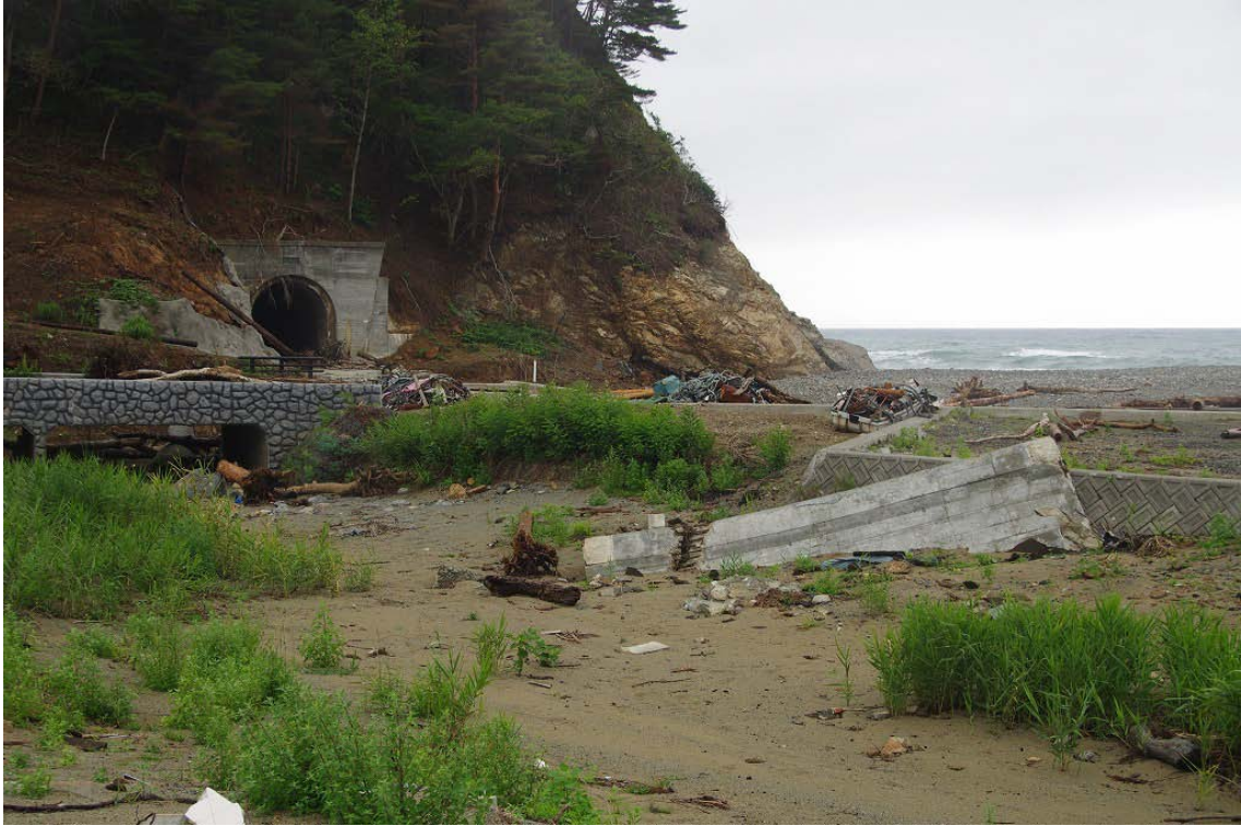
舗装道路は完全に失われている。
